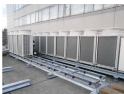
空調設備の更新
